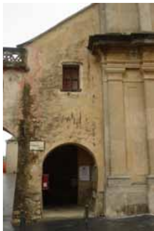
Porticato della cappella seicentesca di N. S. delle Grazie inglobato nella nuova parrocchiale
